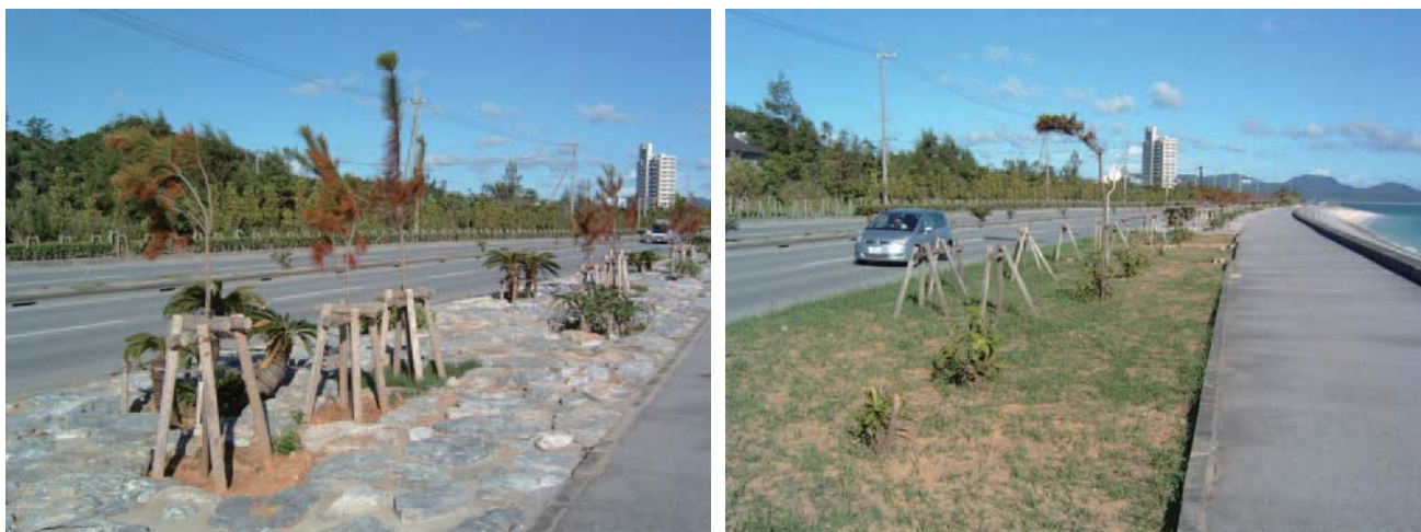
（海岸部の植栽地における樹木の生育不良）
