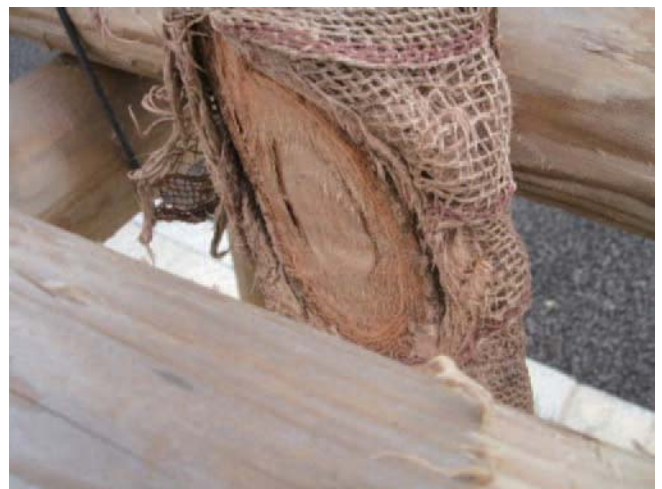
(結束不良による幹の損傷・ブラシノキ)
